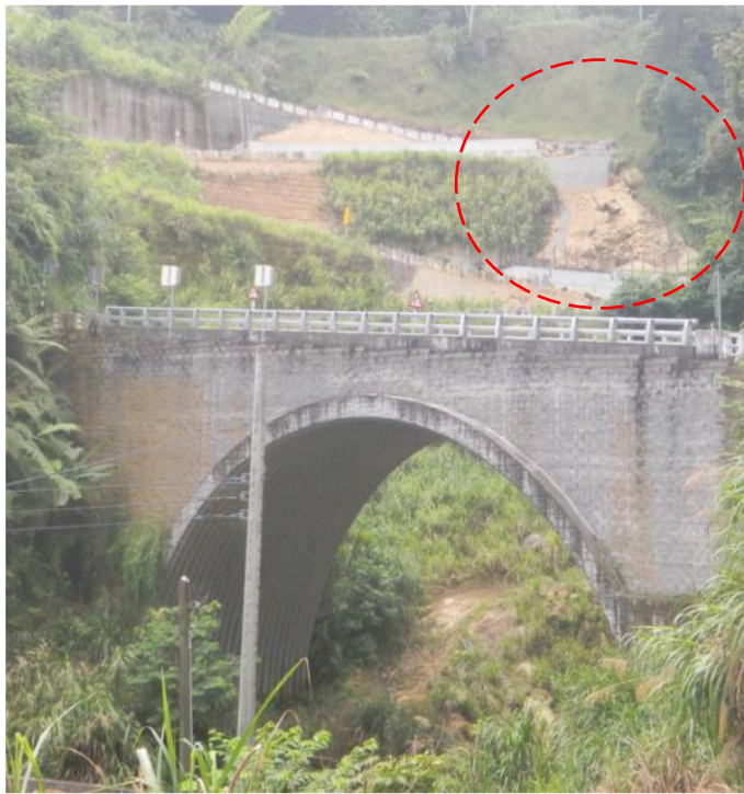
2013년 6월 점검(인근 도로 파손)
